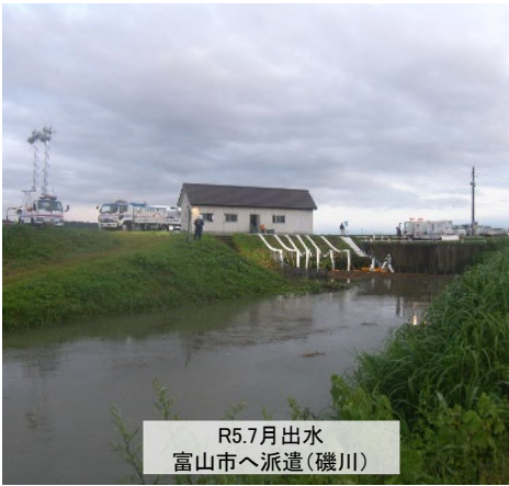
【参考】排水ポンプ車稼働の様子
