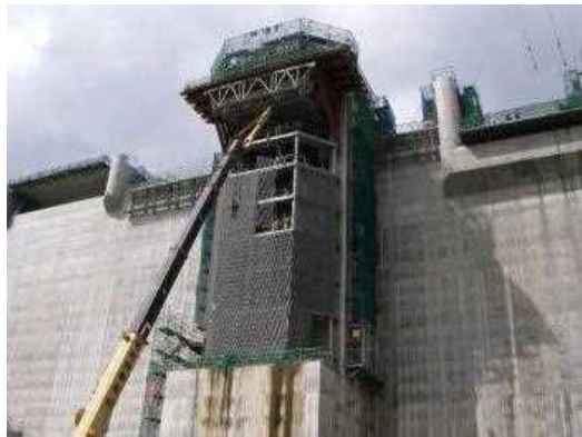
選択取水設備 (他ダム事例)
