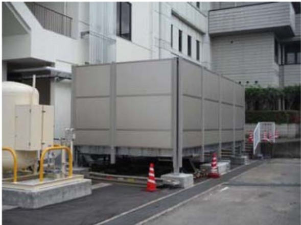
屋外機器 据付場所
