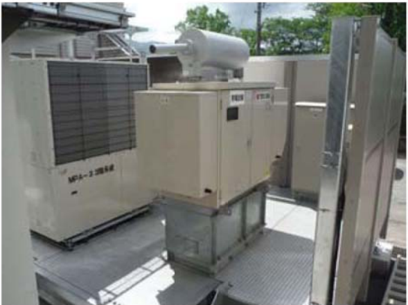
非常用発電機等 据付状況
