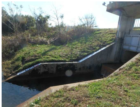
量水標 設置状況
