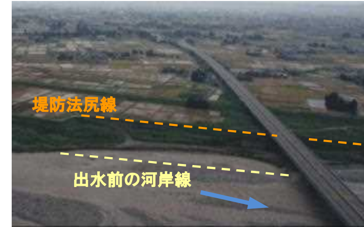
平成10年洪水による被災状況(左岸10.6k)
