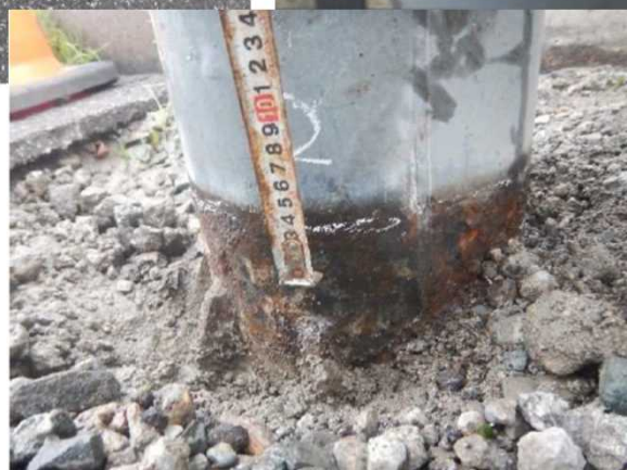
掘削後の腐食状況
