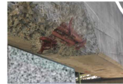
損傷状況(鉄筋露出)
