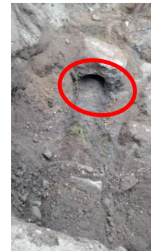
横断水路継ぎ目部に隙間が発生
