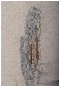
コンクリートの剥離・内部鉄筋の錆
