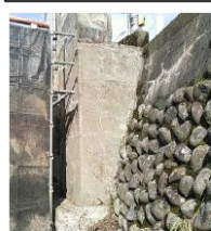
〈A2橋台 損傷状況〉
