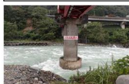
〈P1橋脚 洗掘状況〉
