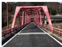
〈トラス部 腐食状況〉
