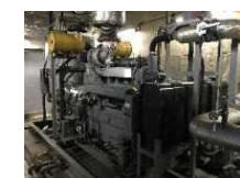
＜自家発電装置＞
