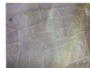
下部工のひび割れ
