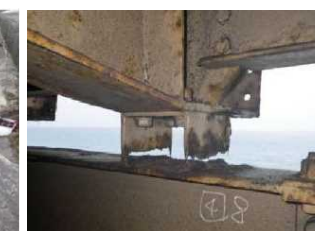
▲シェッド主梁端部破断
