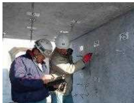
<ひび割れ判読例>
