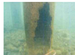
▲橋脚水中部の断面欠損
