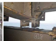
▲シェッド主梁端部破断
