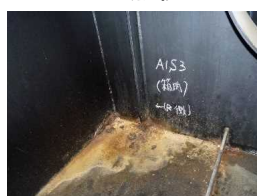
▲桁端部の堆砂
