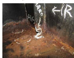
▲桁端部の腐食、断面欠損
