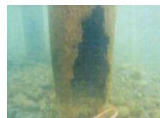
▲橋脚水中部の断面欠損
