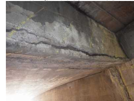
▲桁端部のひび割れ、うき
