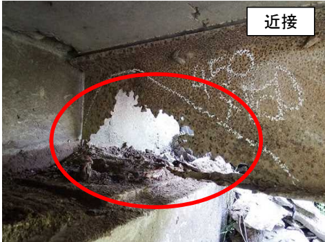
近接目視により断面欠損を確認
