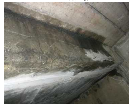
▲桁端部の漏水
