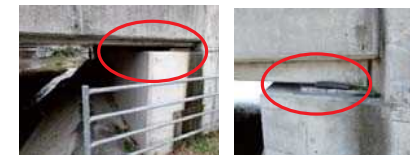
支承交換の作業空間なし
