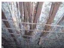
PC鋼材の腐食例
