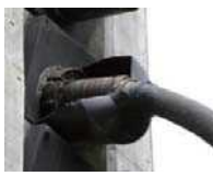
ケーブル損傷例
