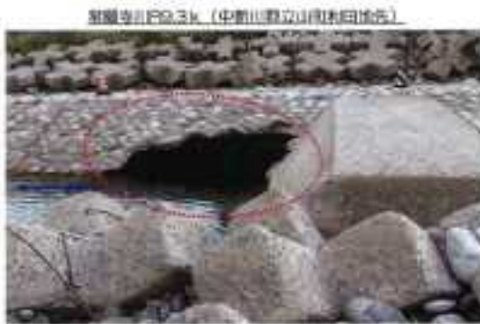
写真 3.3 低水護岸の破損状況
