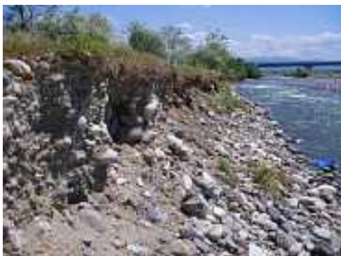
写真 3.1 河岸侵食状況
