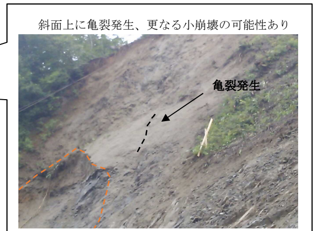
写真15【斜面小崩落状況：拡大】
