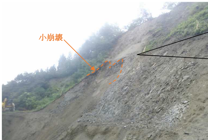
写真14【斜面小崩落状況】
