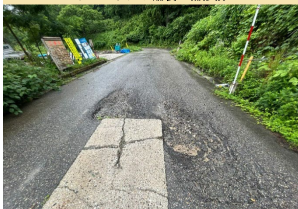
アスファルト舗装 補修前
