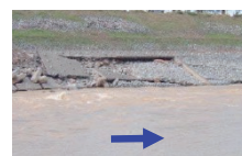
堤防護岸の決壊及び根固め流失(砺波市 庄川町青島地先)
