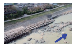
堤防護岸の決壊及び根固め流失(砺波市 庄川町金屋地先)
