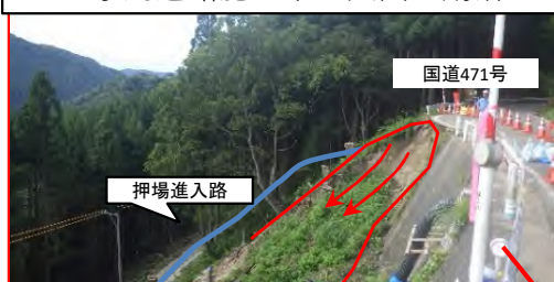
貯水池斜面对策進入路(押場地区) 工事用道路施工中に法面が崩落
