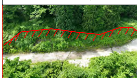
付替市道法面 施工後の法面に変状が発生
