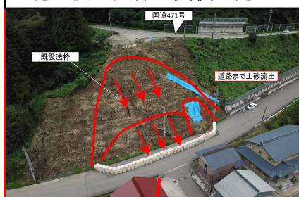
工事用道路法面 施工後の法枠に変状が発生
