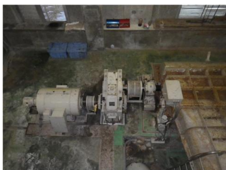
[発電設備（リプレース前）]
