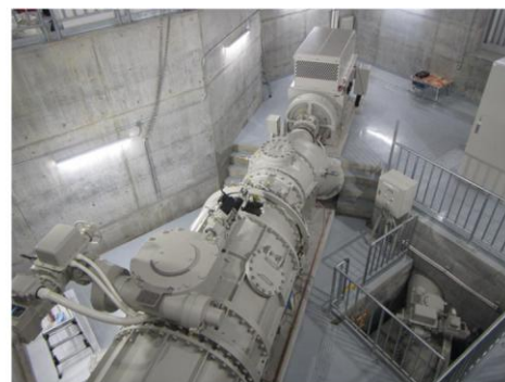
[発電設備（リプレース後）]
