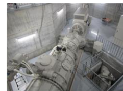
〔発電設備(リプレース後)〕
