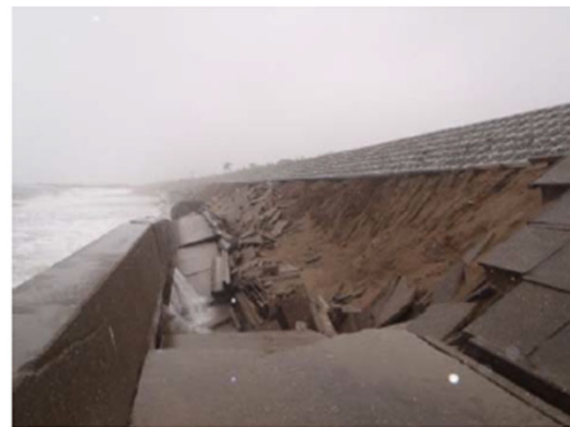
【施設被災状況：小松市安宅地先(2012年12月)】
