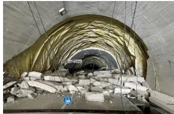
〔国道249号大谷トンネルの被災〕
