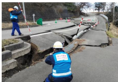
【道路の被災状況調査】
