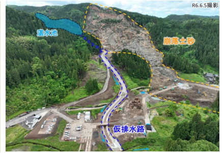
〔河原田川:土砂崩落復旧(輪島市)〕
