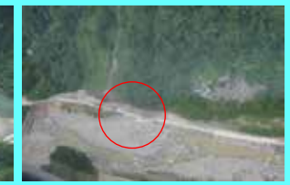
工所用道路の損傷（真川第2号砂防堰堤上流）
