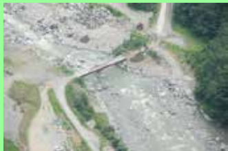
工所用仮橋の損傷（桑谷連絡所付近）
