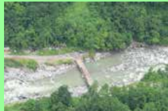
工所用仮橋の損傷（天鳥砂防堰堤下流）
