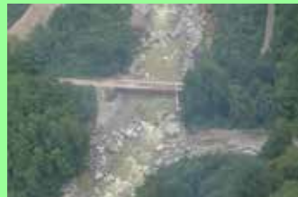
工所用仮橋の損傷（鬼ヶ城砂防堰堤下流）
