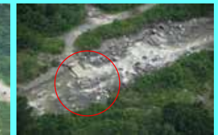
渡河施設の流出（水谷第4号砂防堰堤上流）
