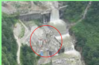
仮締切・仮設資材の被災（サブ谷砂防堰堤）
