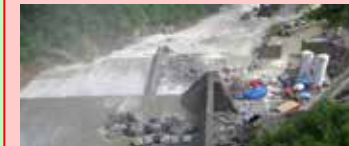
仮締切・仮設資材の被災（サブ谷砂防堰堤）
