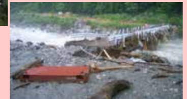
工所用仮橋の損傷（天鳥砂防堰堤）
