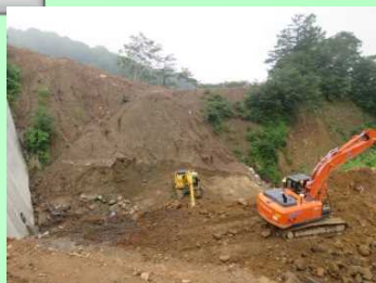
7. 27出水後の状況
