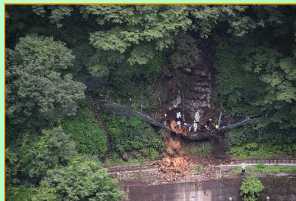
工事専用軌道沿い斜面の土砂崩落状況 (大谷付近)
