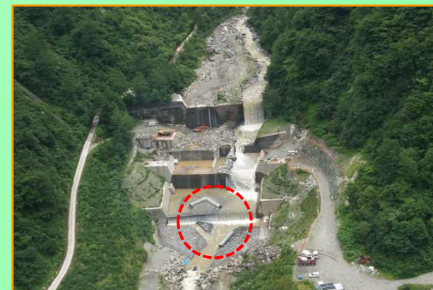
工事仮設物の被災状況 (水谷第3号砂防堰堤)
