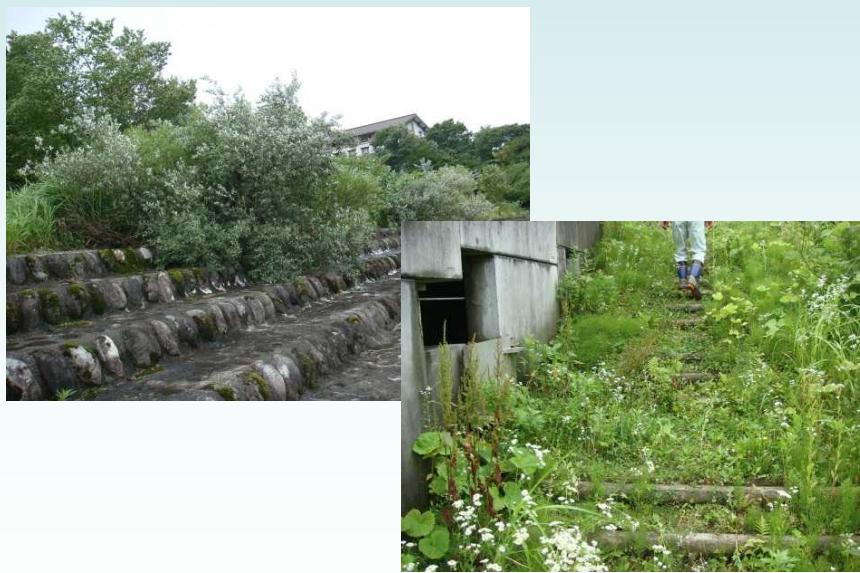
雑草が繁茂しており通路の除草を検討 (立山1号公園、本宮水辺の楽校)
