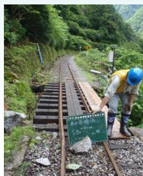
軌条の損傷状況(七郎付近)
