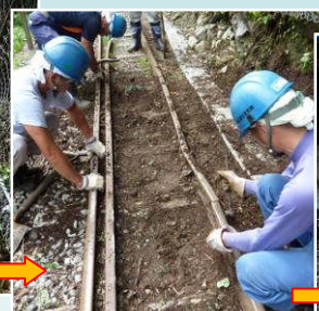
軌条(レール)の損傷状況 (ワサビ谷付近)
