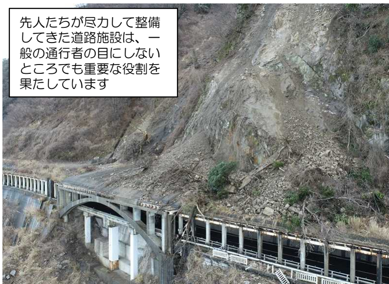
向山洞門上部の斜面崩壊と崩落した土砂、岩塊、倒木の状況
