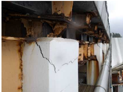
コンクリートの劣化
