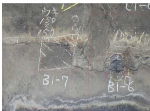
コンクリートの劣化
