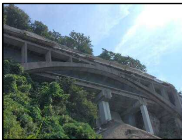
写真 - 6 布製型枠変異状況
