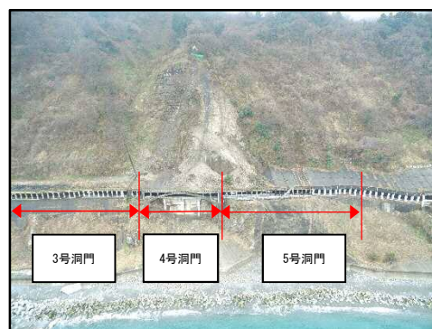
写真 - 2 法面崩落状況（4月撮影）
