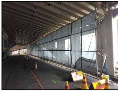
写真 - 3 洞門内への落石防護
