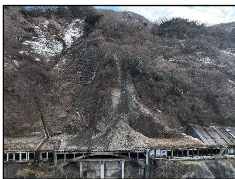
写真 - 1 法面崩落状況（1月撮影）
