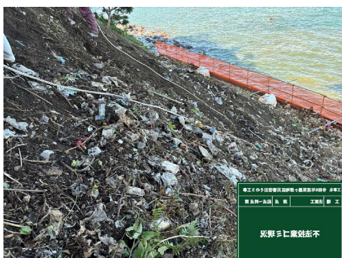
写真-3 ゴミの飛散状況
