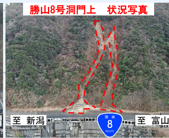
糸魚川市青海(勝山8号・11号洞門) 被災延長 L=340m 令和5・6年度糸魚川管内維持工事
