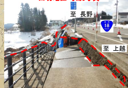
田切地区 状況写真
