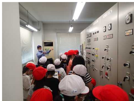
水戸の川排水機場内の操作室
