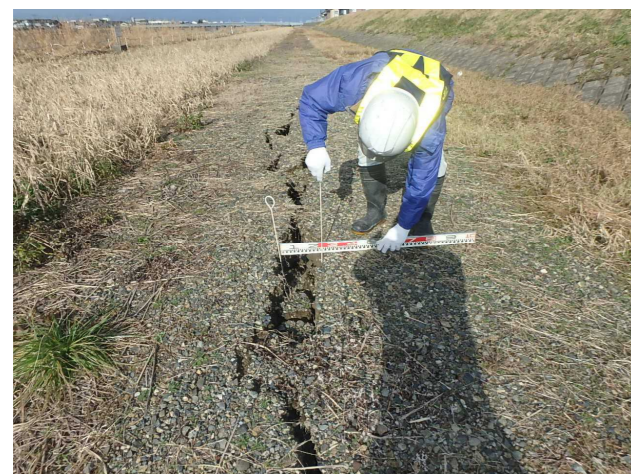
堤防坂路および管理用通路 被災状況
