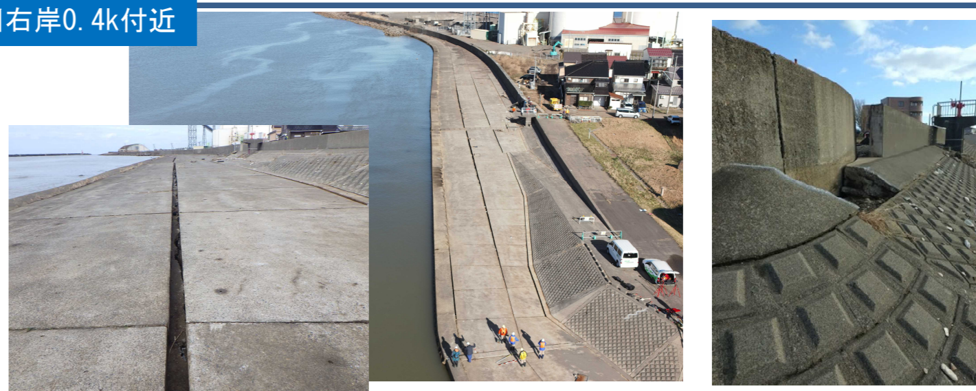
コンクリート目地の開き 及び 堤防損傷状況
