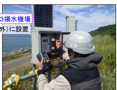
風向風速計点検状況
