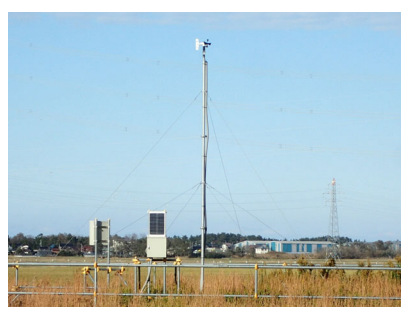
風向風速計設置状況
