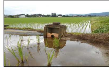
田んぼダム排水口の例(排水口にゲートを設置)
