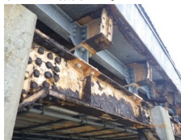
写真-2 腐食した梁部材
