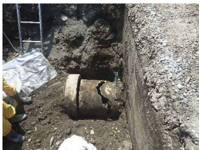
写真 - 1 ヒューム管破損状況
