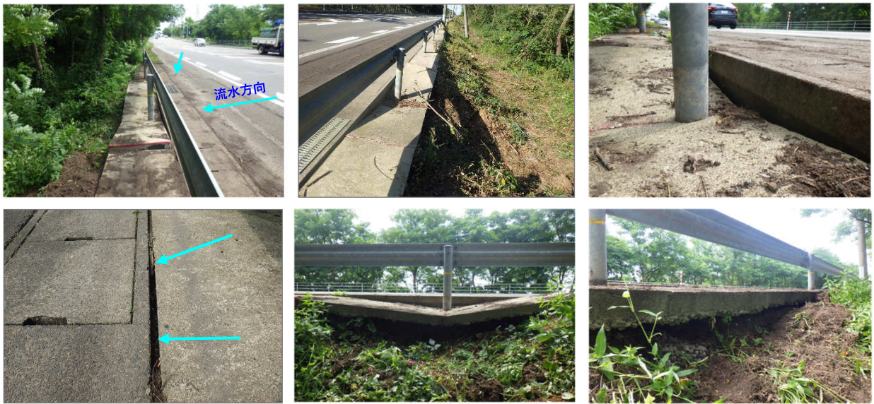
写真-2 路面排水が流れ込み 路肩が洗掘されている
