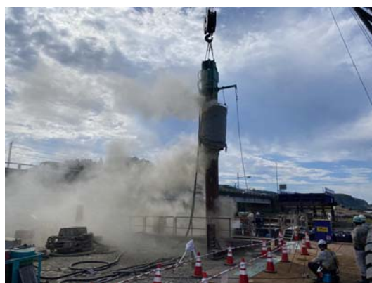
写真2 粉塵発生状況(他現場)
