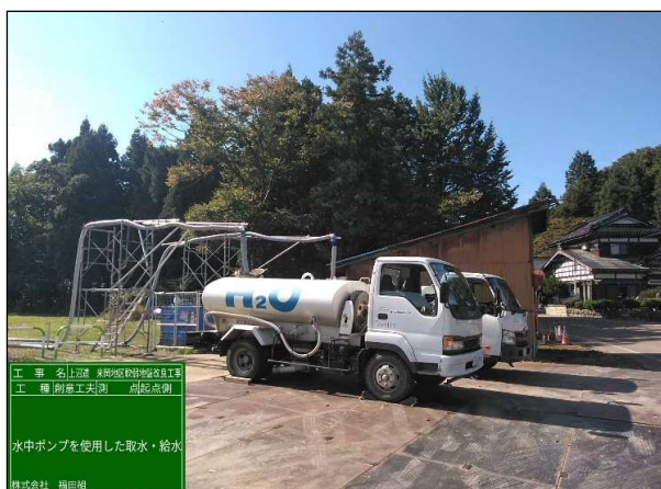
写真-10. 散水車給水設備（2台分）
