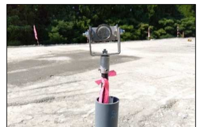
写真-4. 沈下板プリズム
