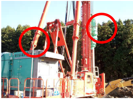
写真-3 GNSS アンテナ
