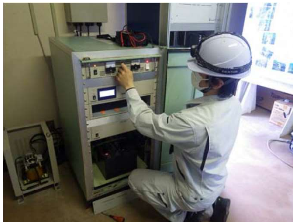
電源装置点検
