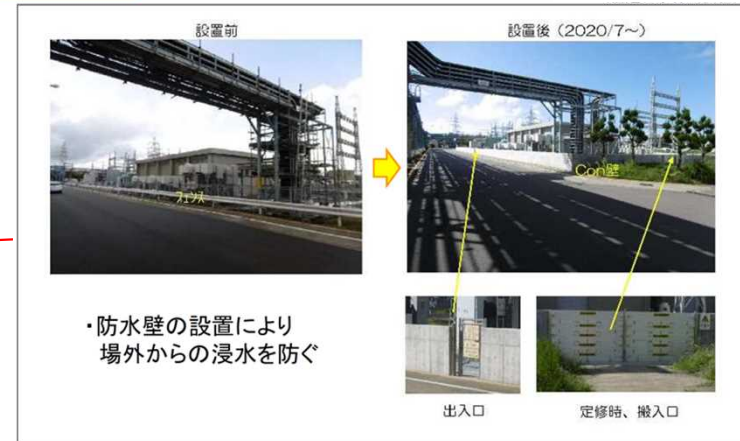
防水壁設置状況
