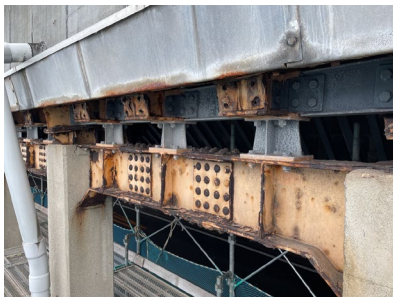
写真-1 傷んだ鋼材
