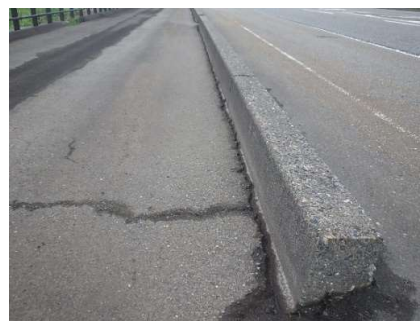
舗装と縁石に隙間が出来た
