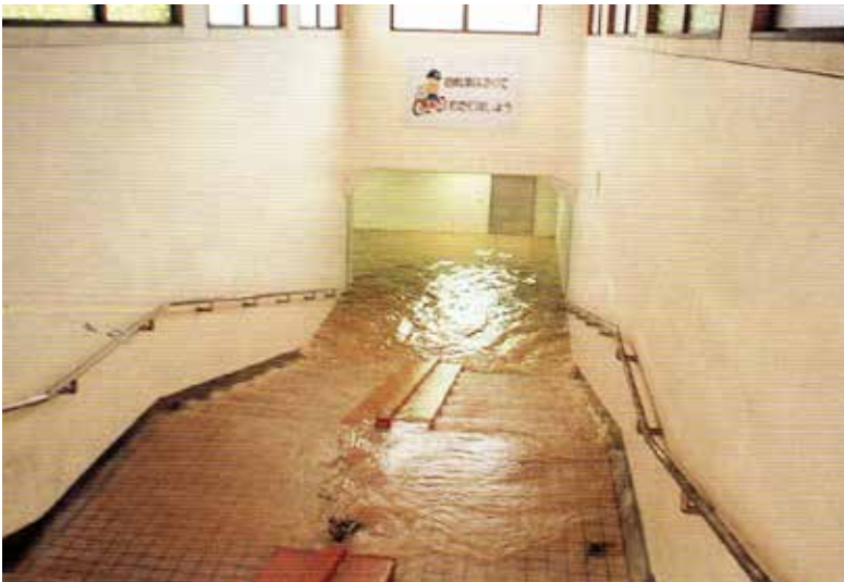
地下横断歩道が浸水した。
